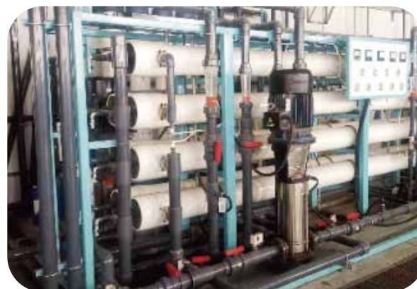
吉林油田炼化厂污水深度处理回用, 4800m 3 /d, RO膜
