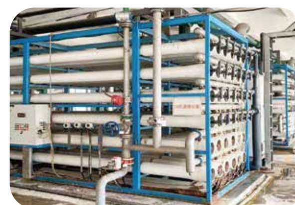
沈阳某电力行业给水, 4500m 3 /d, RO膜
