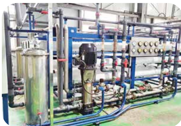
江西某垃圾渗滤液工程 2000m 3 /d
