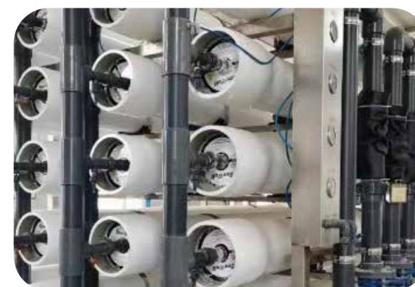
山东青岛某电镀给水, 600m 3 /d, RO膜
