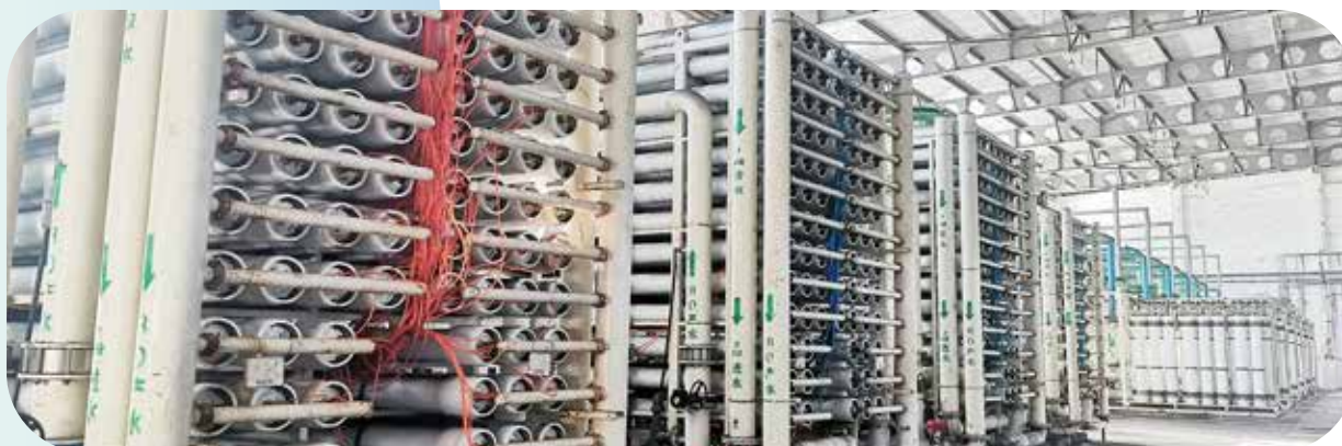
新疆某煤制天然气循环水补给, 3.6万m 3 /d, RO膜
