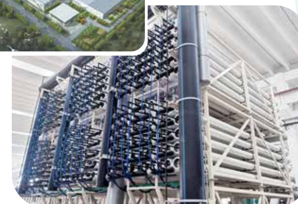
山东鲁北海水淡化一期工程，5万m 3 /d，UF+RO
