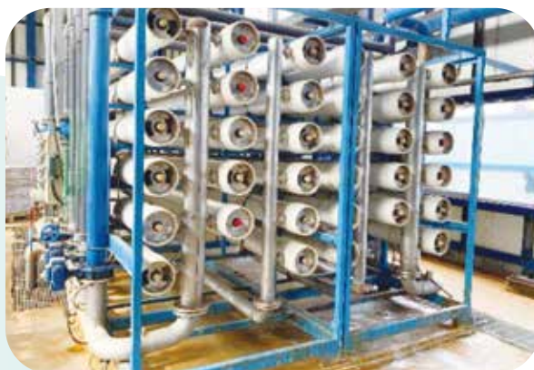
山东某石油化工污水处理回用, 2000m 3 /d, RO膜
