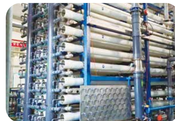
北京某电子行业给水, 5000m 3 /d, RO膜
